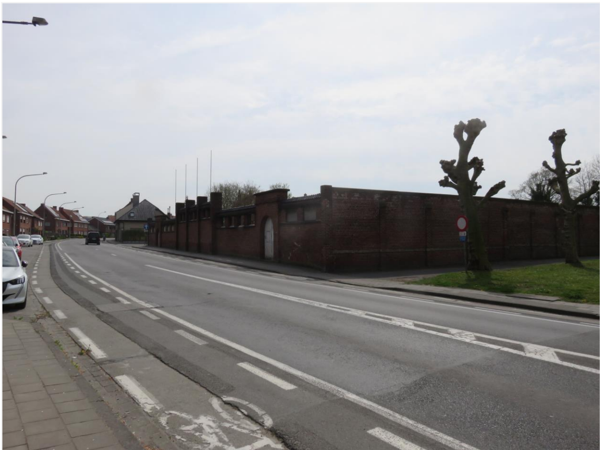
Foto 6: Zicht op de noordelijke en westelijke afsluitingsmuur van het openluchtzwembad Ieper ter hoogte van de Basculestraat (agentschap Onroerend Erfgoed 28 april 2021).
